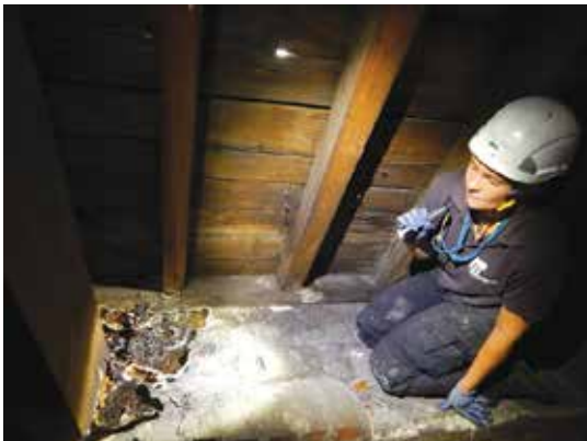
Şekil 6. Çatı arası incelemeleri sırasında gözlemlenen bozulmalar (© Monumentenwacht Vlandereen - Flaman Anıt İzleme Örgütü).
