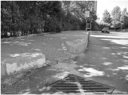
Hatalı rampa düzenlemesi, İstanbul (Avlar, 2012)
